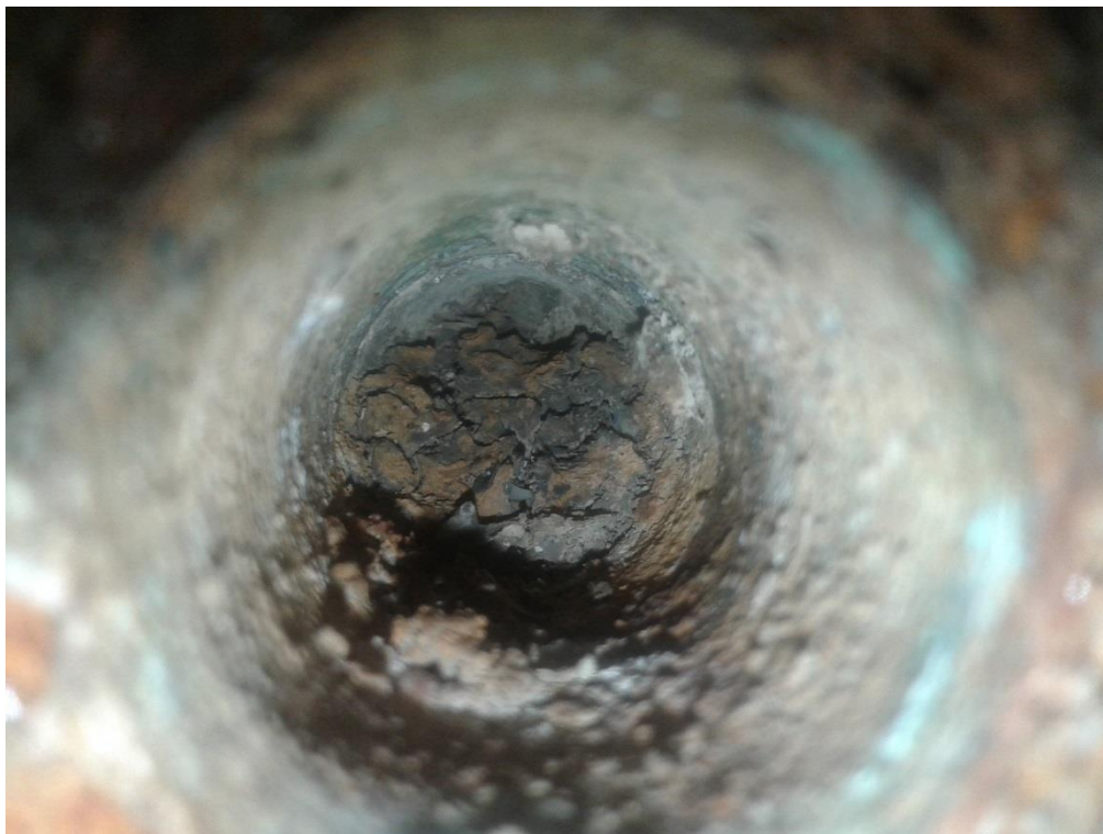
Рисунок 3 Состояние трубок до промывки
