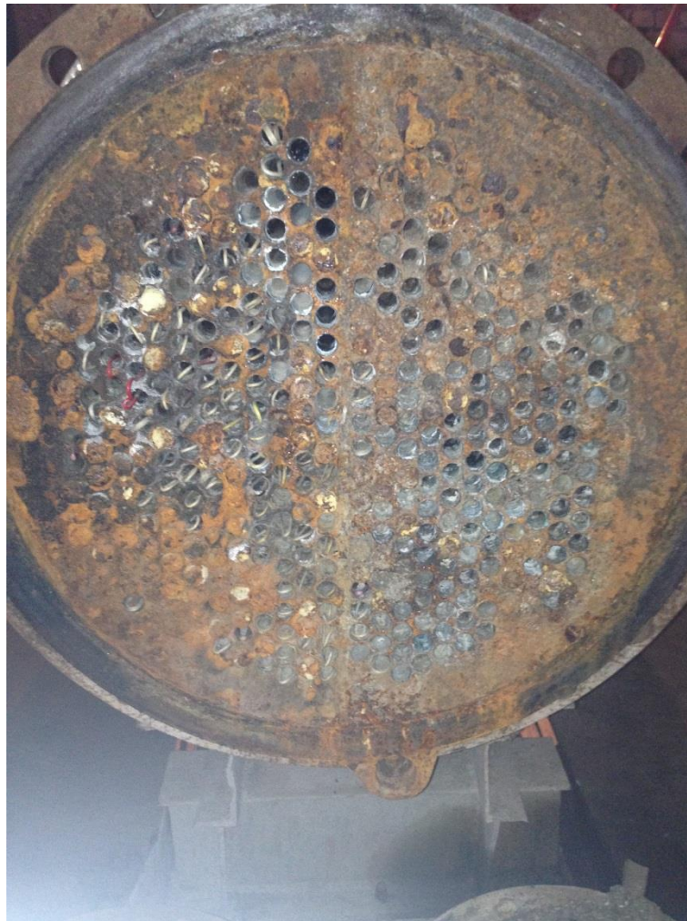
Рисунок 2 Состояние трубного пучка до промывки
